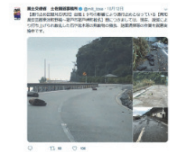
令和元年10月12日 国道55号 高知県安芸郡東洋町～ 室戸市室戸岬町通行止め状況
