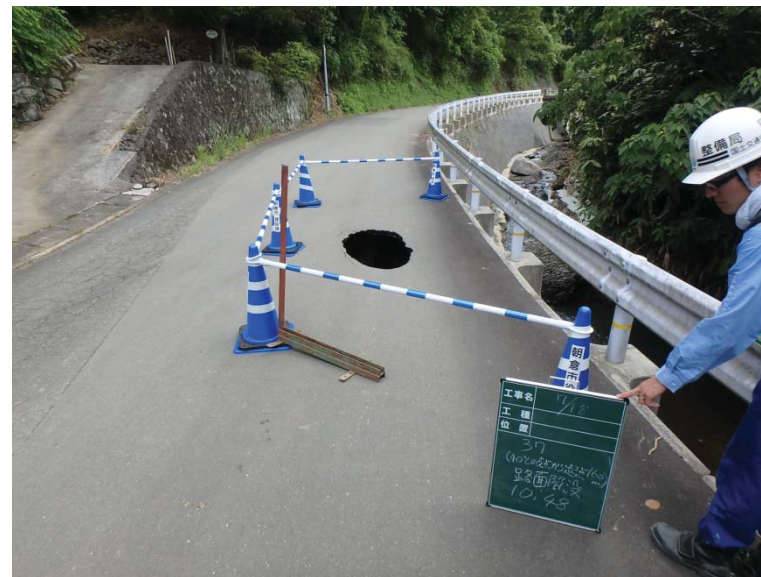
道路陥没状況①
