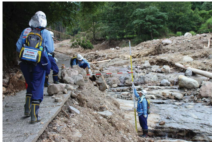
河川の被害状況調査①
