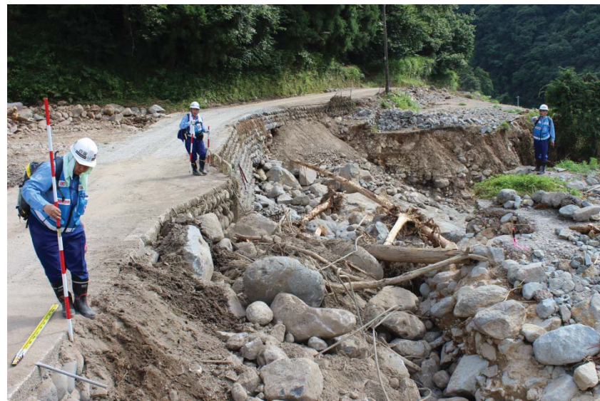
河川の被害状況調査②
