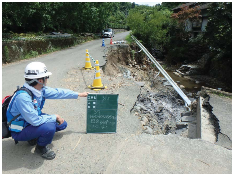
道路(路肩)崩壊状況
