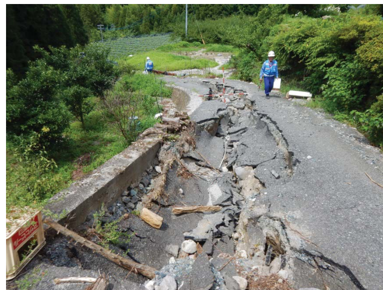
道路陥没状況②
