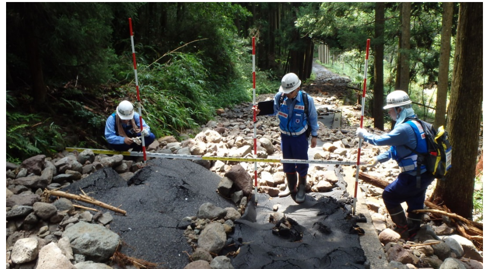
道路崩壊状況
