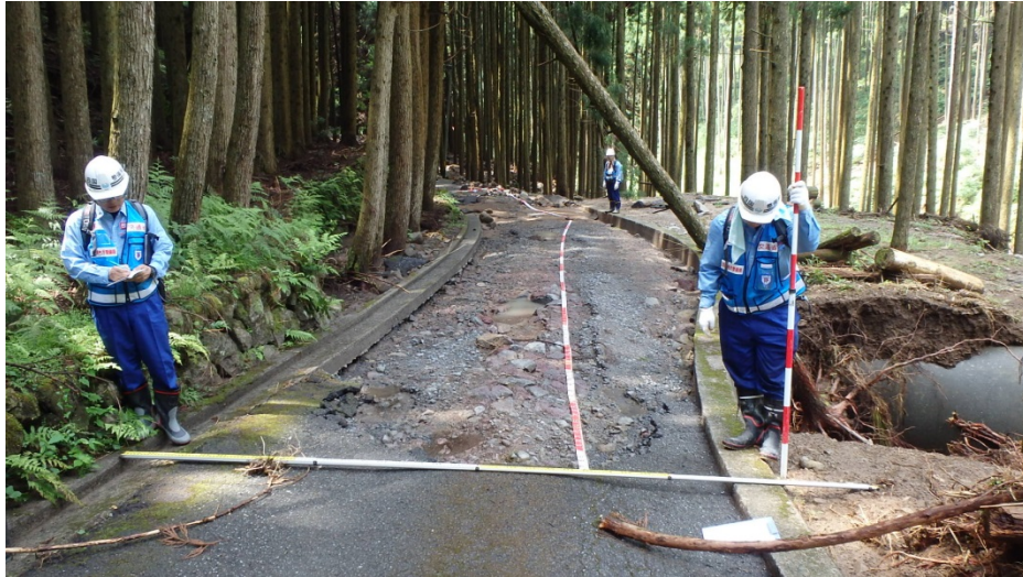
道路(舗装面)流出状況
