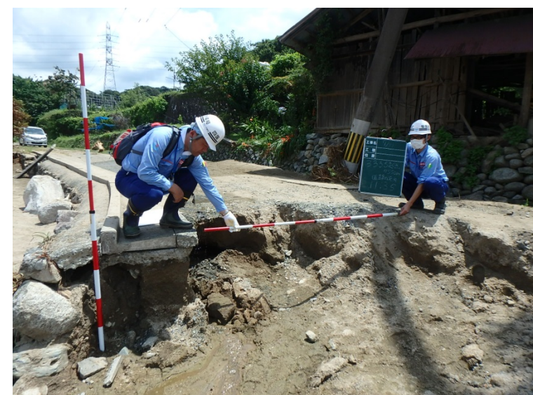
道路の被害状況調査
