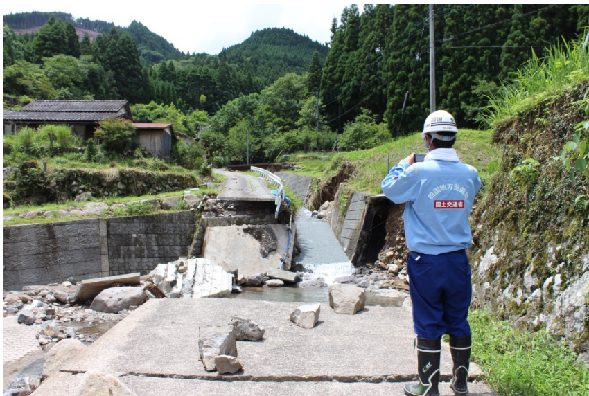
崩落した橋の被災状況調査
