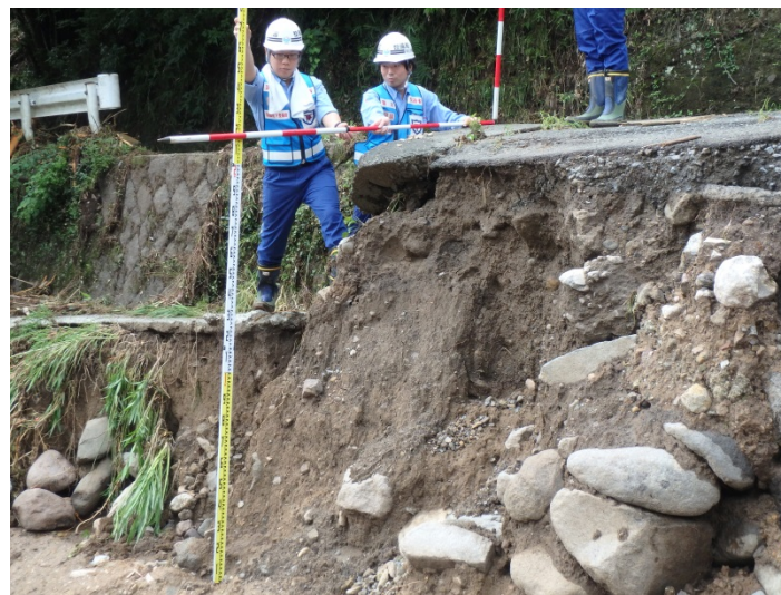
崩落した道路の被災状況調査
