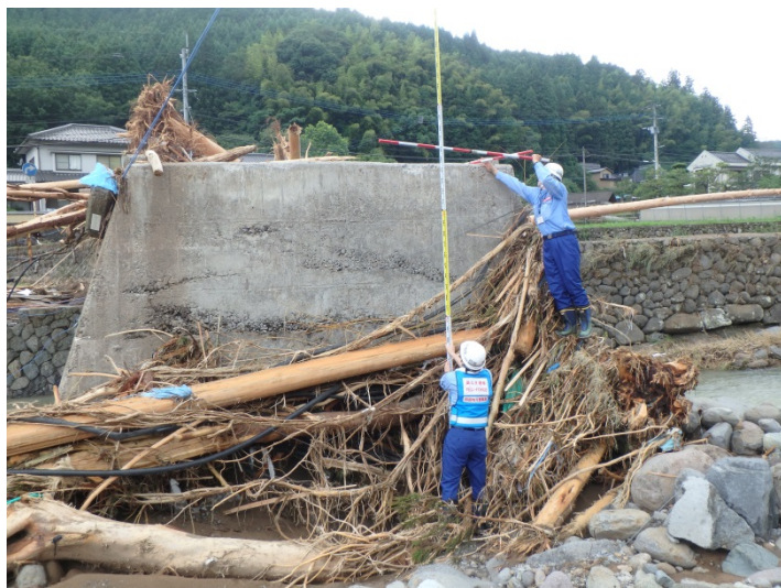
流された橋梁の被災状況調査
