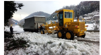
車両牽引状況
