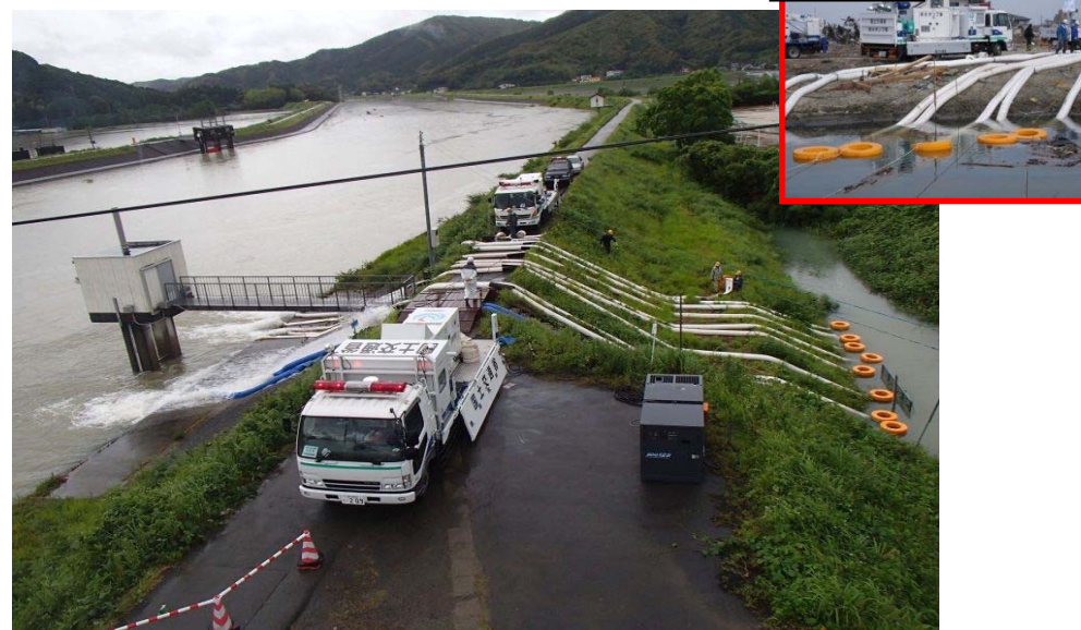
ポンプ稼働状況(イメージ)
