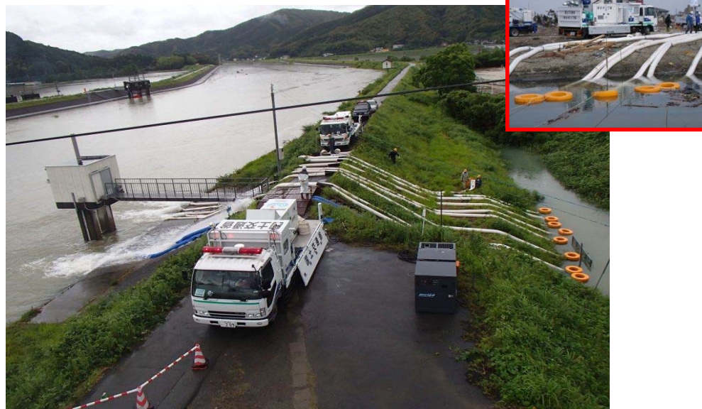
ポンプ稼働状況(イメージ)
