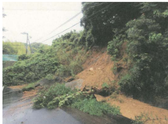
被災箇所B 町道王無線 法面崩壊
