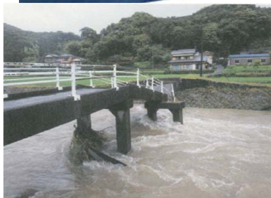
被災箇所A 法寿院橋町道ヒジリノモト線
