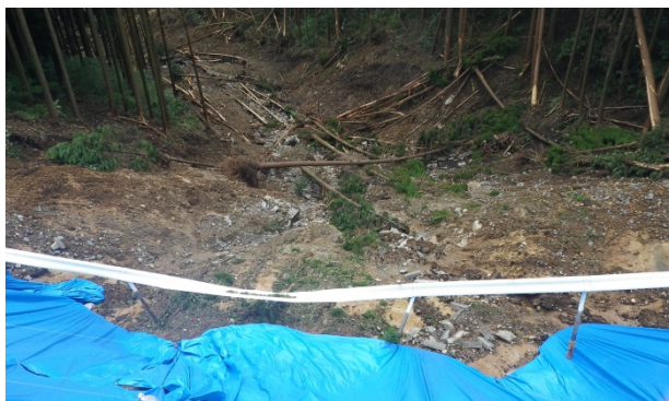
道路法面崩壊下斜面の被災状況
