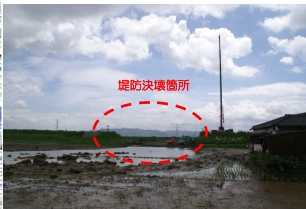
矢部川堤防決壊地点 (矢部川右岸7k300)
