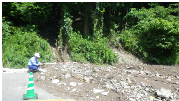
道路法面崩壊箇所の土砂流出状況
