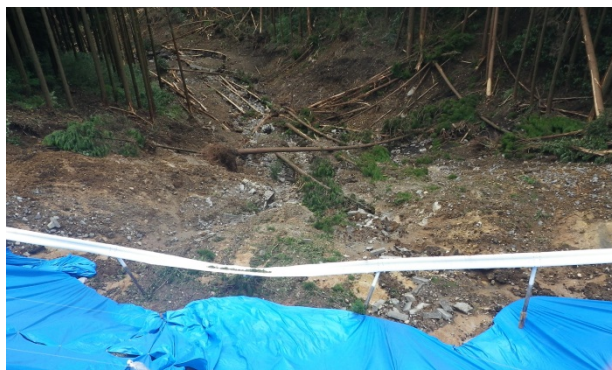
道路法面崩壊下斜面の被災状況
