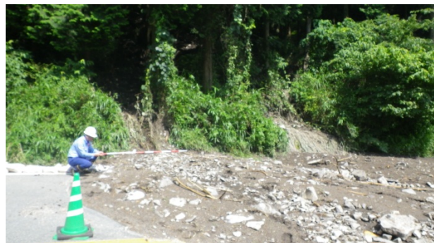
道路法面崩壊箇所の土砂流出状況
