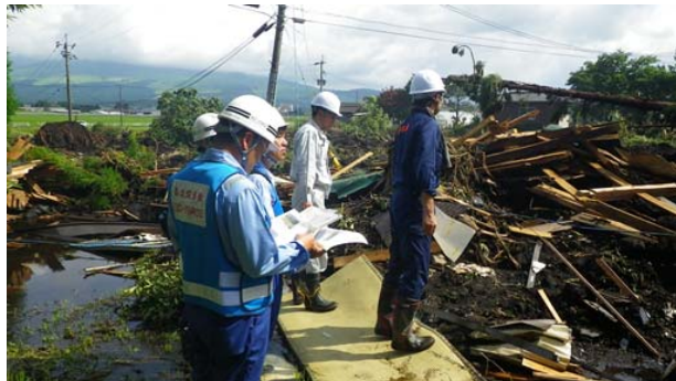
土砂災害被災状況視察
