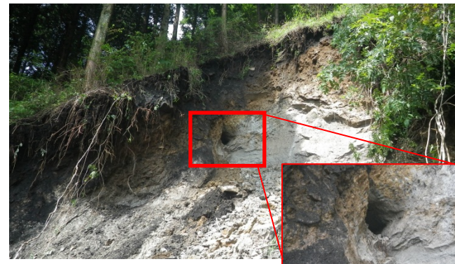
道路法面崩壊箇所上にできたパイピング現象
