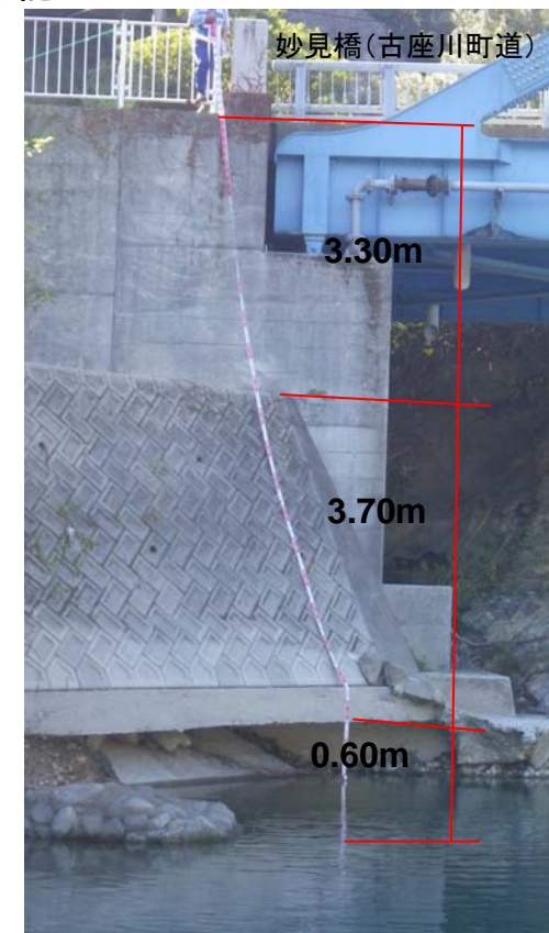
条件護岸の損傷 (吸出し)
