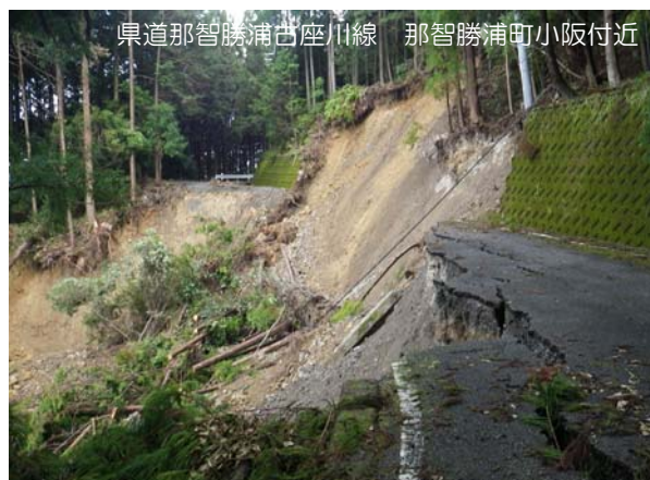
法面崩壊、道路崩落
