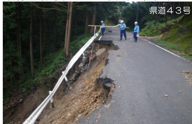
路肩崩壊 (L≒47m)
