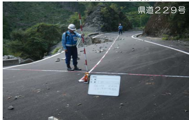
路肩崩壊 (L≒26m)
