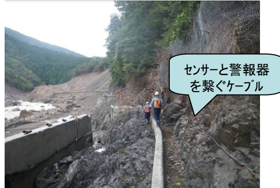
斜面に設置されているケーブル
