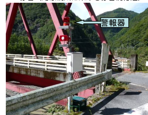
赤谷下流側に設置されている警報器
