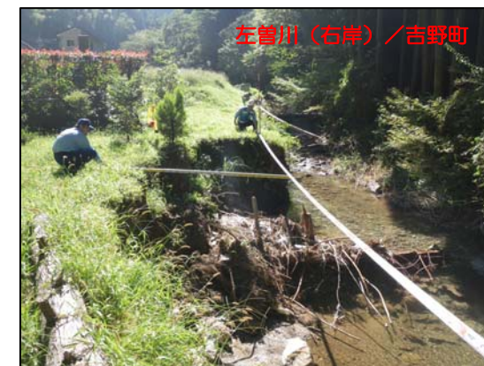
石積み護岸の被災調査状況
