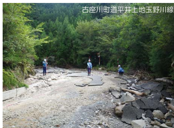
路面（舗装）破損
