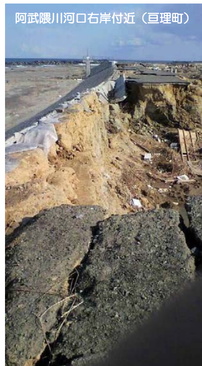
河川堤防裏の被災状況
