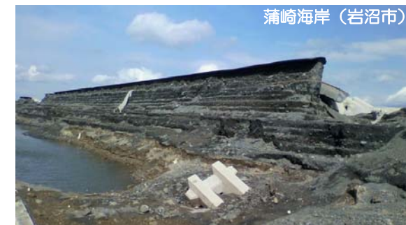
海岸堤防の津波による裏法面の洗掘状況
