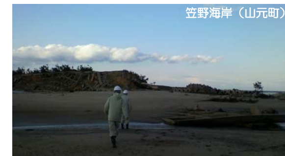
海岸堤防の被災状況
