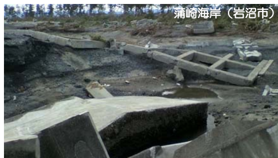
堤裏のブロックが松林まで流されている状況
