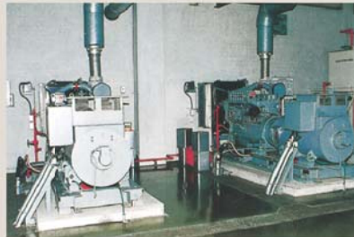
予備電源装置
