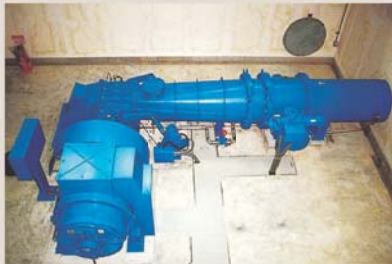
小水力発電施設
