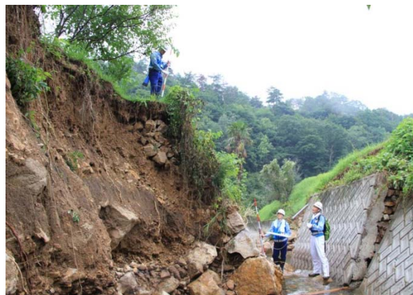
〔河川班の被災調査〕
