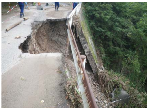
〔道路班の被災調査〕
