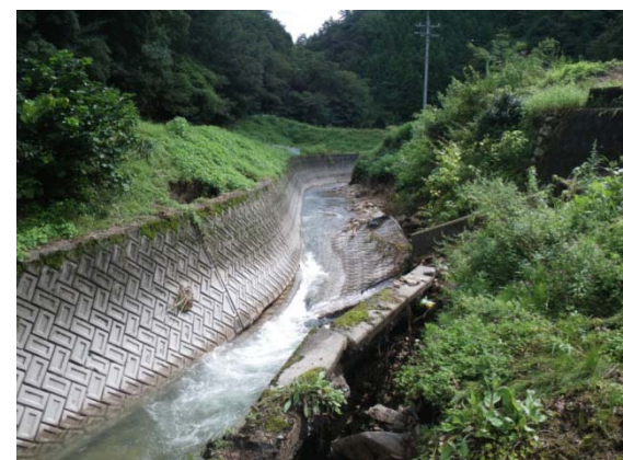
〔河川班の被災調査〕
