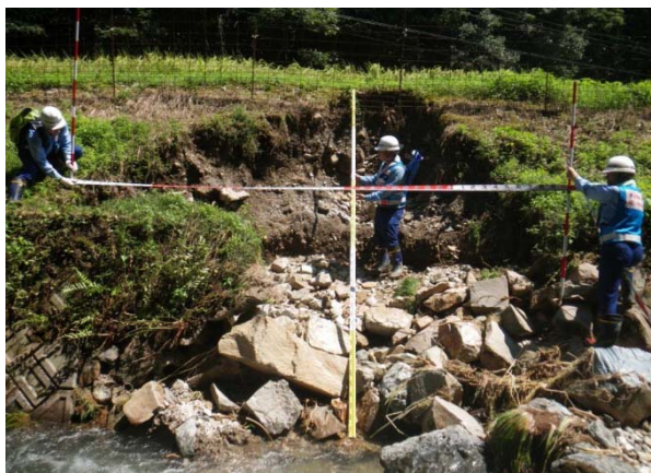
〔河川班の被災調査〕
