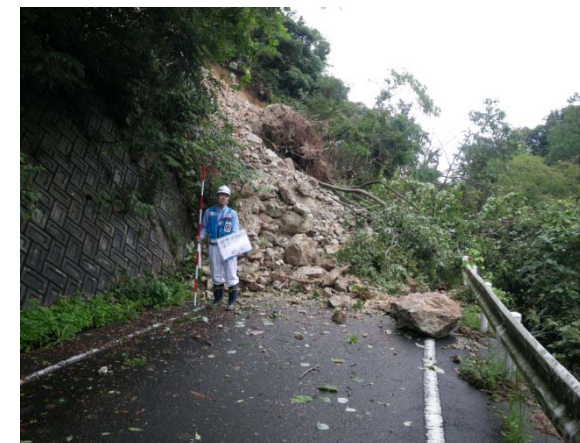
〔道路班の被災調査〕
