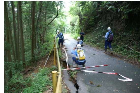
〔道路班 市道中津坂線の被災調査〕
