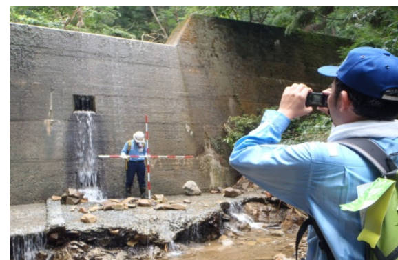
〔砂防班 奥畑堰堤の被災調査〕
