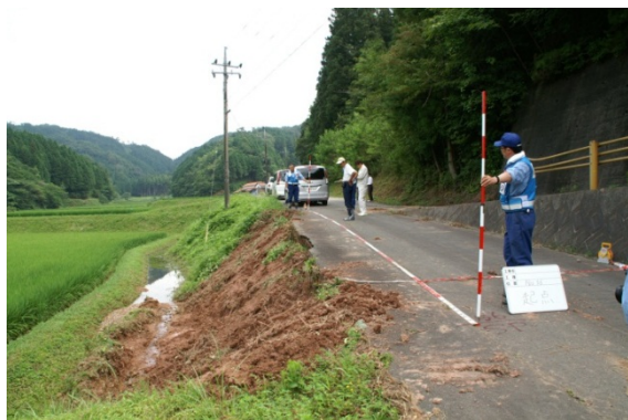
〔道路班 市道札の奥線の被災調査〕
