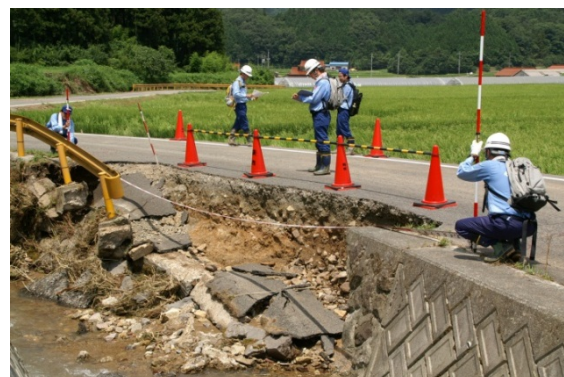
〔河川班 阿武川水系支川大迫川の被災調査〕
