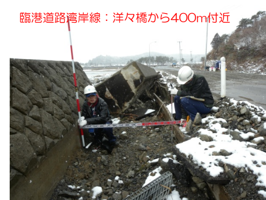
臨港道路湾岸線：洋々橋から400m付近 護岸波返し部の倒壊、歩道の損壊
