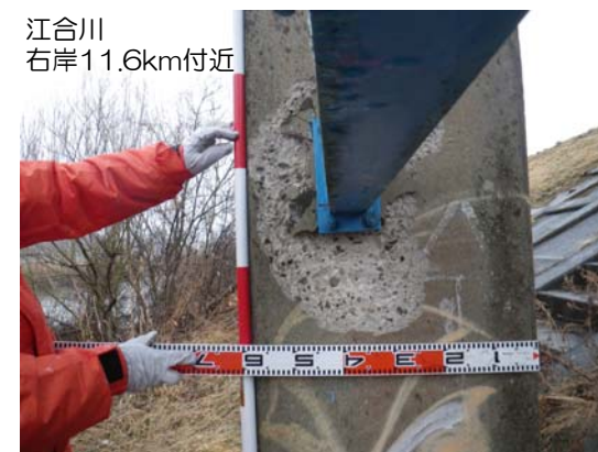
樋門門柱のコンクリートのはく離
