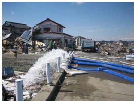
〔排水ポンプ車の稼働状況〕
