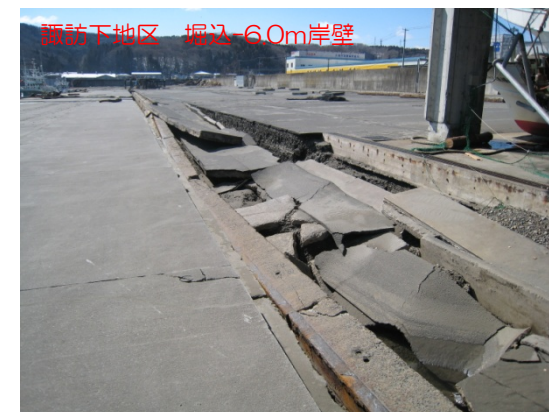
諏訪下地区 掘込-6.0m岸壁 棧橋構造の渡橋版の損壊、飛散状況
