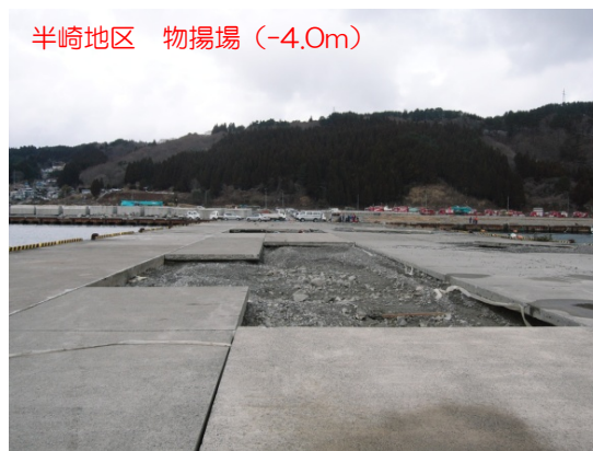
半崎地区 物揚場 (-4.0m) コンクリート版の沈下・剥離、流出が発生
