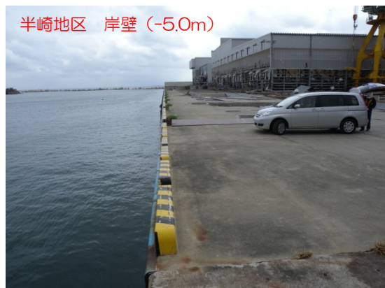
半崎地区 岸壁 (-5.0m) 岸壁法線、車止め、係船柱、防舷材損傷無し
