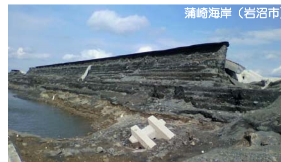
海岸堤防の津波による裏法面の洗掘状況
