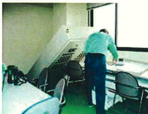
【地震で倒壊した制御盤】 (資料提供：(財)東北電気保安協会)
