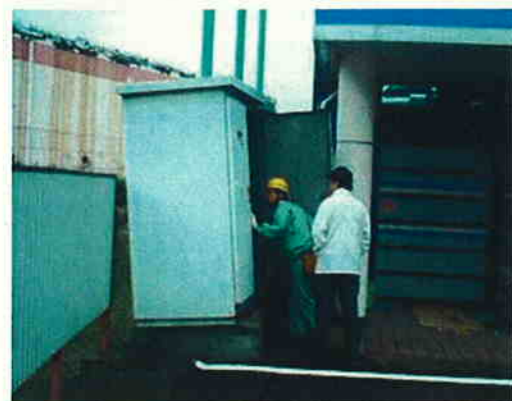
【地震で移動したキュービクル】 (資料提供：(財)東北電気保安協会)
